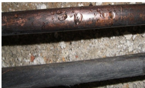
Beschadigde hydraulische leiding
